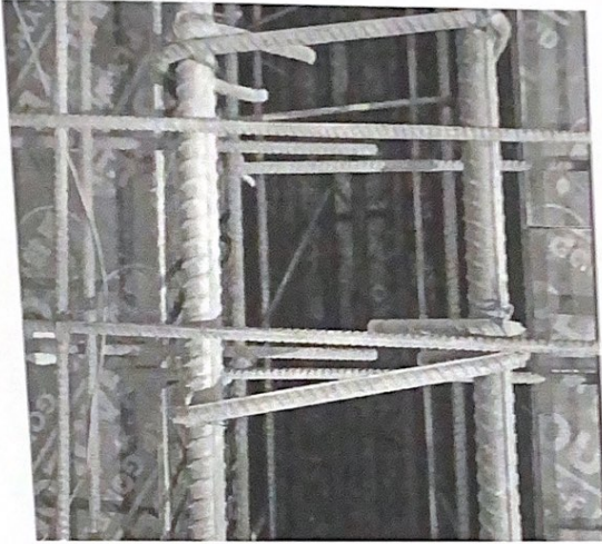
框架梁内部钢筋拉钩未绑扎到位，现场出现拉钩脱落
