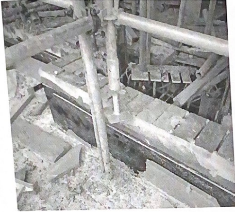
外立面脚手架底部悬空
