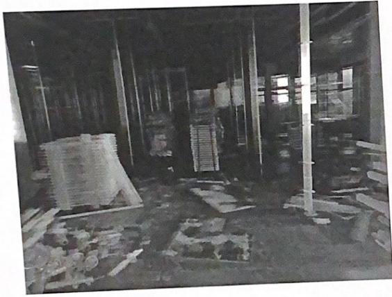
地下室拆卸脚手架时，地下室照明不足主要进出通道未设置照明灯具，影响人员安全；
