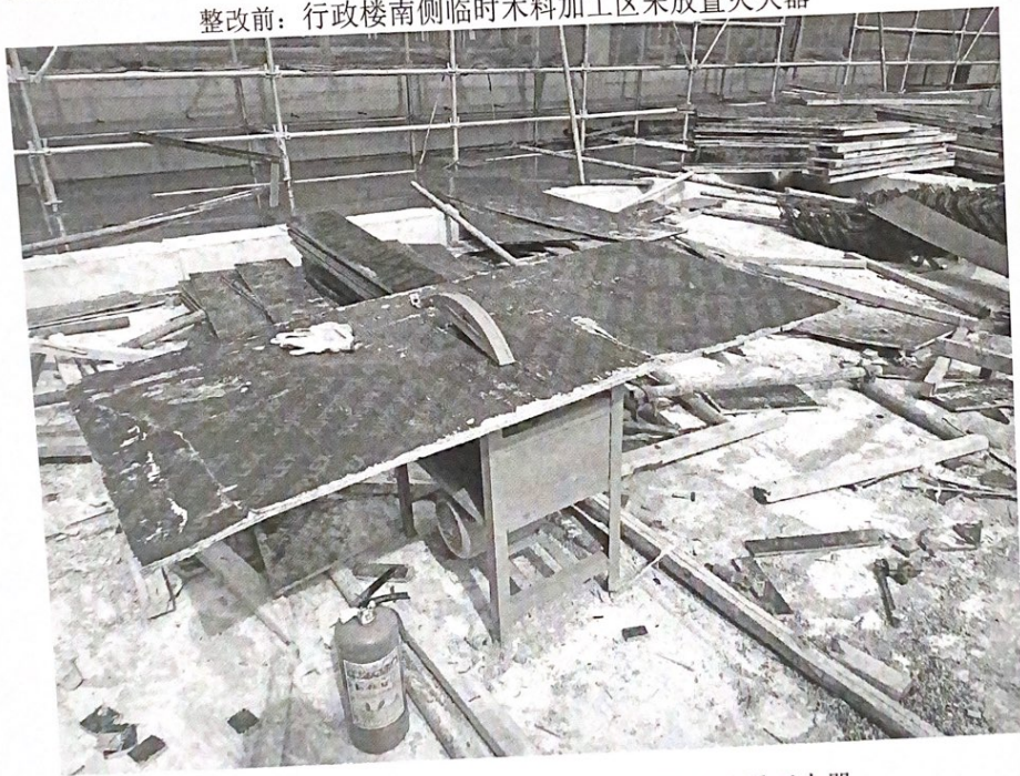
整改后：行政楼南侧临时木料加工区已设置灭火器
