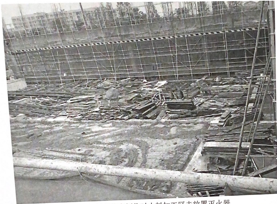
整改前：行政楼南侧临时木料加工区未放置灭火器
